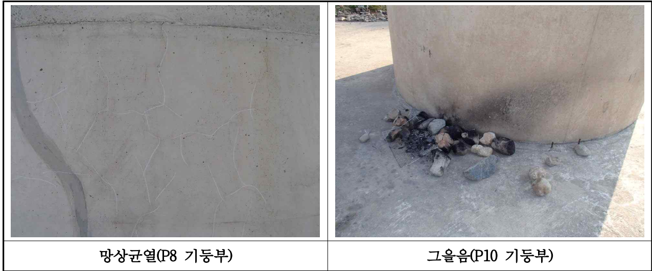
【사진 3.3.7】 교각 손상현황(부산, 계속)
