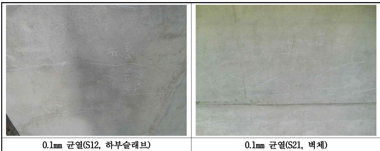
【사진 3.2.3】 PSC BOX 거더 외부 손상현황(대구)
