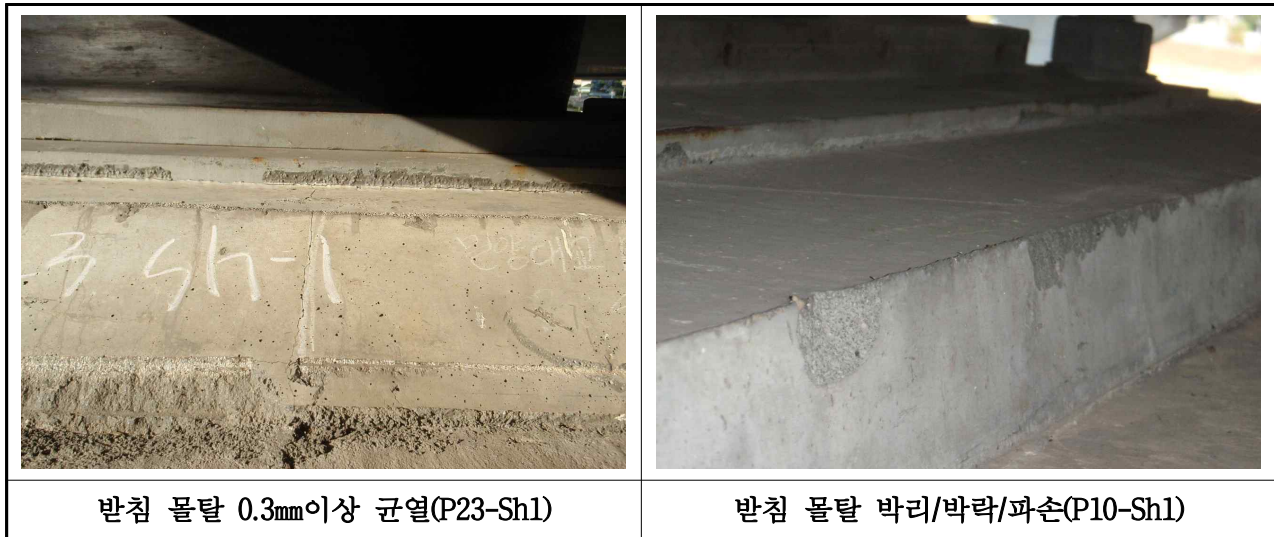
【사진 3.2.10】 교량받침 손상현황(대구, 계속)
