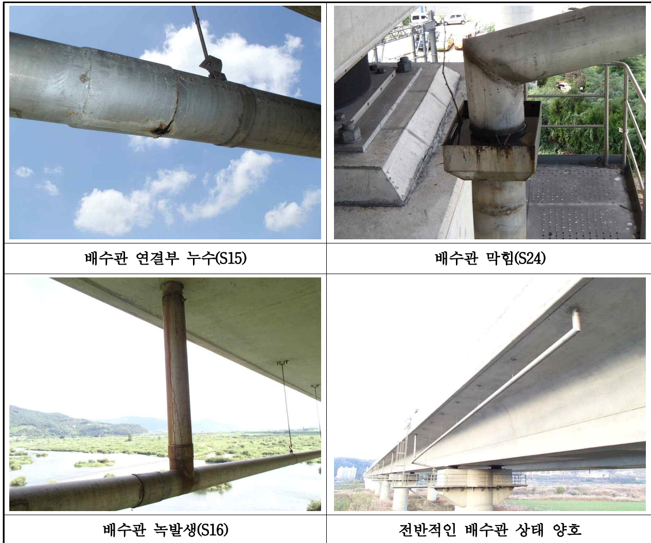
【사진 3.3.17】 배수시설 손상현황(부산)
