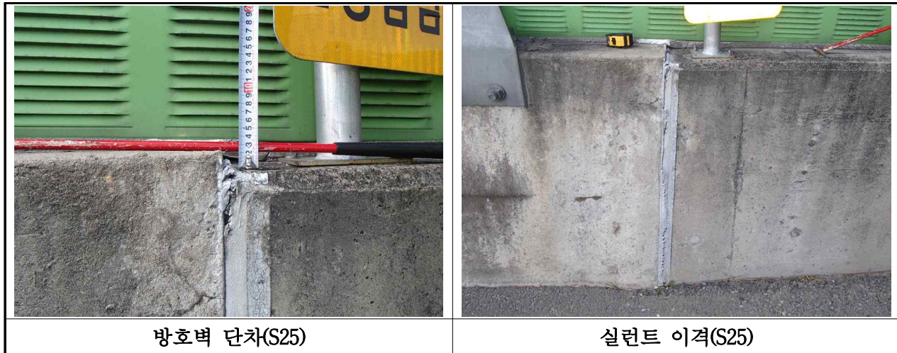
【사진 3.3.19】 방호벽 손상현황(부산, 계속)
