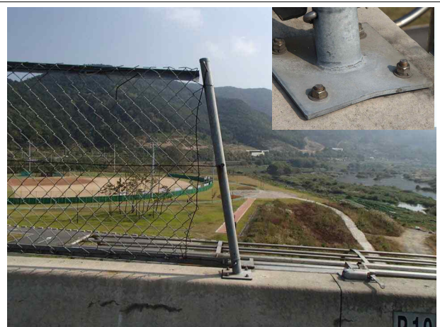
낙하물방지망 지주변형(S17, 지지부 용접 균열)
