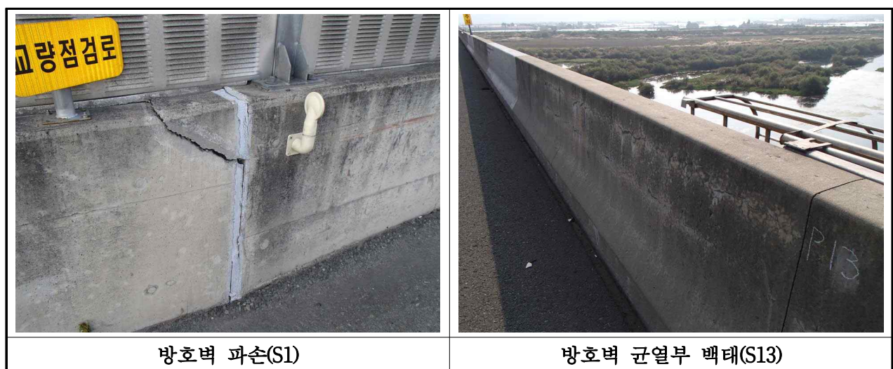
【사진 3.3.19】 방호벽 손상현황(부산)
